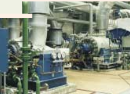
Kesselspeisepumpe mit einer Antriebsleistung von 19 MW in einem 550 MW Dampfkraftwerk Boiler feed pump with a drive rating of 19 MW in a 550 MW steam power plant
